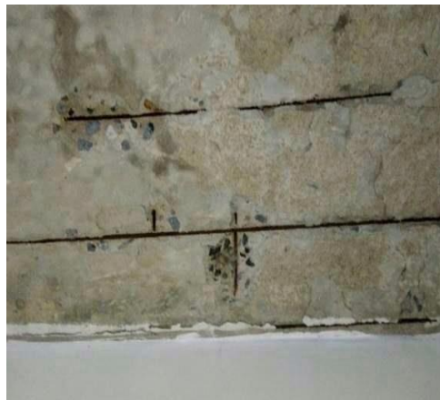
Figura 8- Corrosão de armadura.
