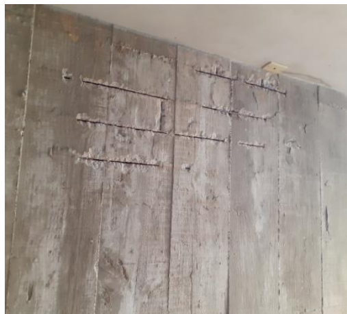
Figura 7- Corrosão de armadura
