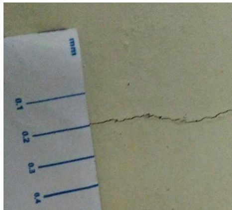
Figura 4 – Fissura em parede.
