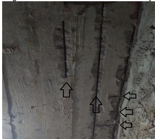
Figura 3 – Corrosão de armadura em laje.
