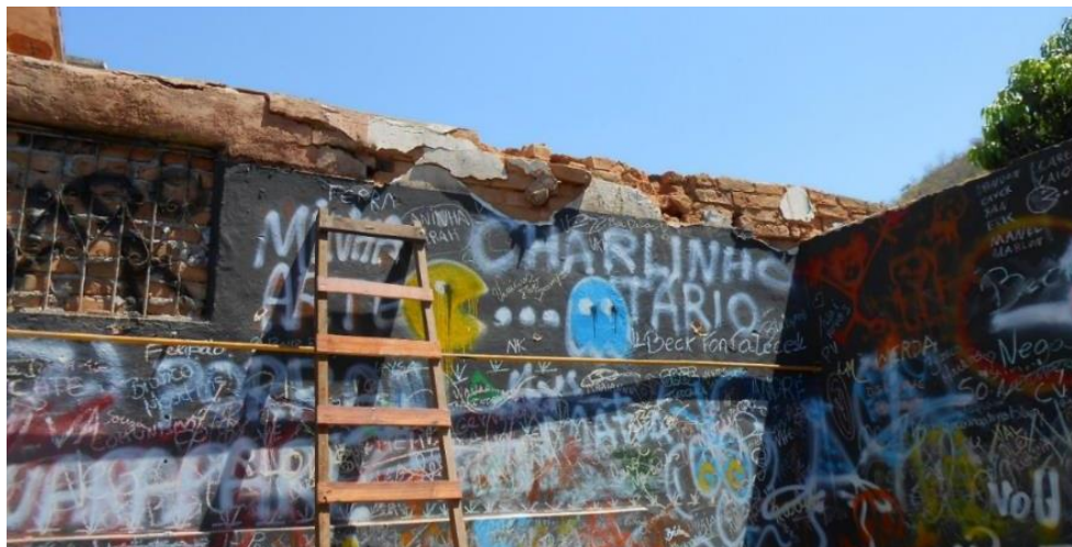
Figura 5 - Desprendimento do reboco
